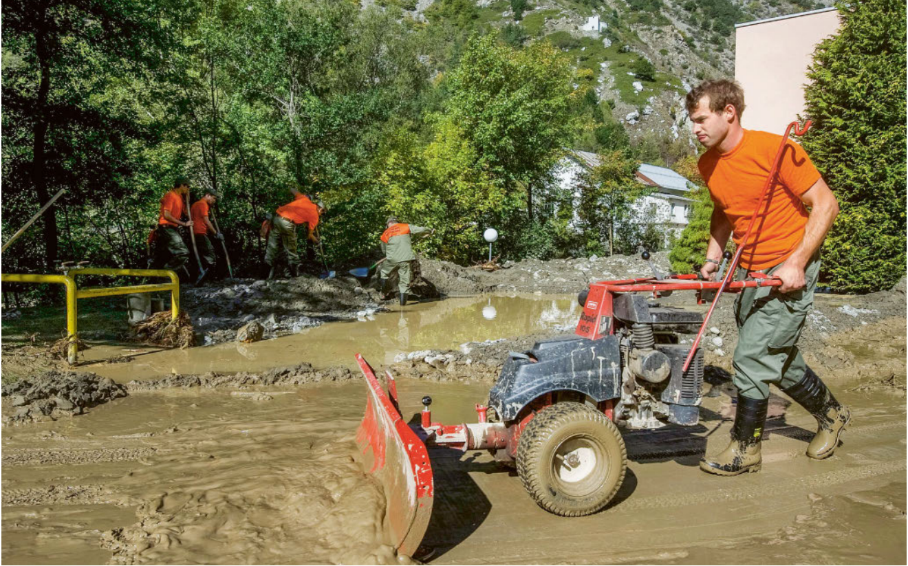
Aufräumarbeiten bei Gampel-Steg (VS) nach dem Hochwasser im Oktober 2011
